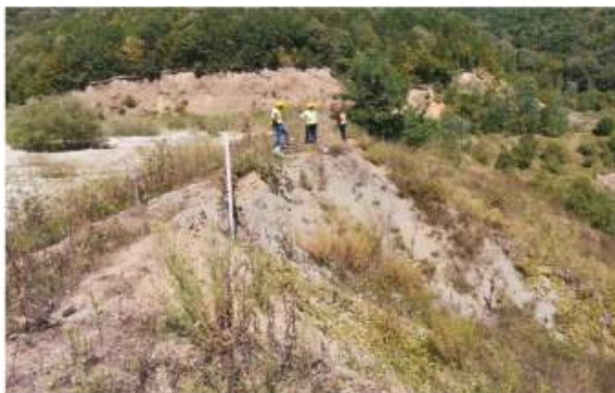
Slika 10.14. - Klizište prouzrokovano dejstvom vode na krunu i spoljašnju kosinu zemljane brane jalovišta "Šaški Potok", avgust 2019. g.
