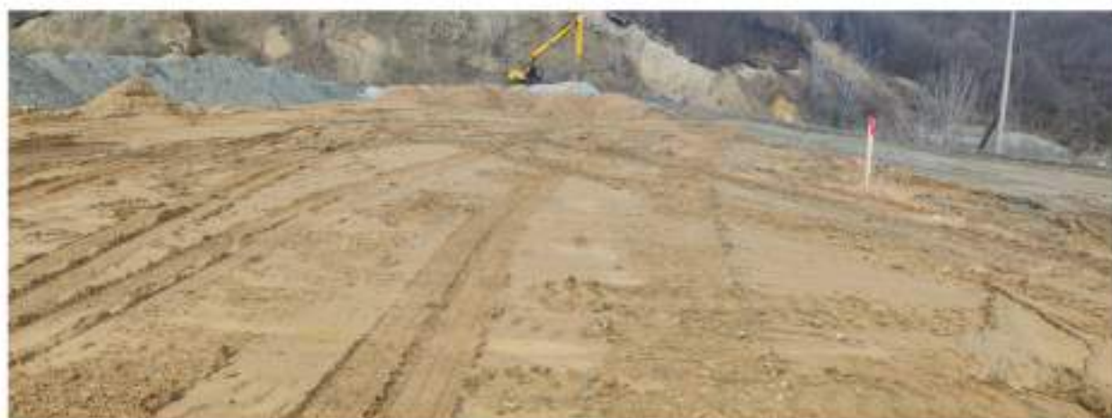
Slika 10.18. – Deo krune brane koja se trenutno sanira i nadvišava, snimljeno tokom obilaska februara 2022.god.
