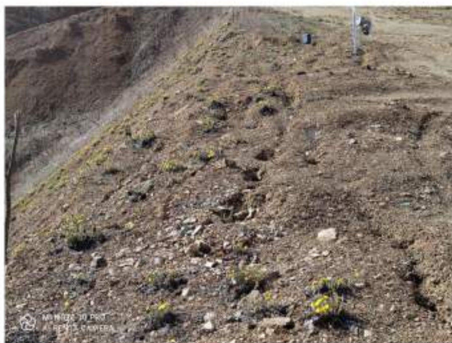
Slika 10.16. – Deo krune brane u desnom boku ugrožen klizanjem materijala usled neadekvatne ugradnje, snimljeno tokom obilaska aprila 2021.god.
