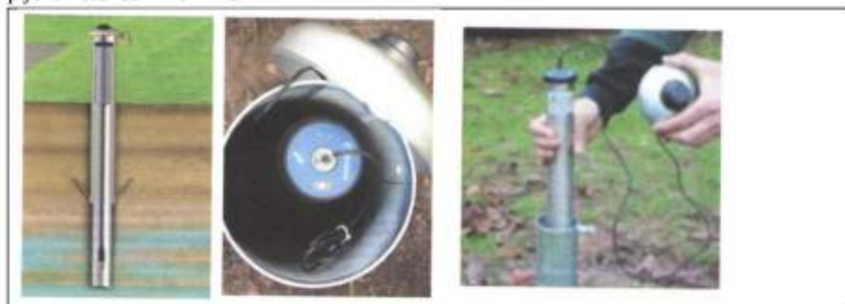
Slika 10.21.: a) Presek pijeziometra sa ugrađenim Diver-om; b) Postupak ugradnje Diver-a u pijeziometar; c) Izgled ugrađenog Diver-a, pogled sa vrha pijeziometarske cevi
